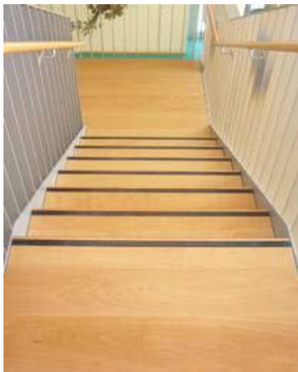
Erleichtertes Erkennen von Treppenanstieg und Stufen dank kontrastreichen Streifen
