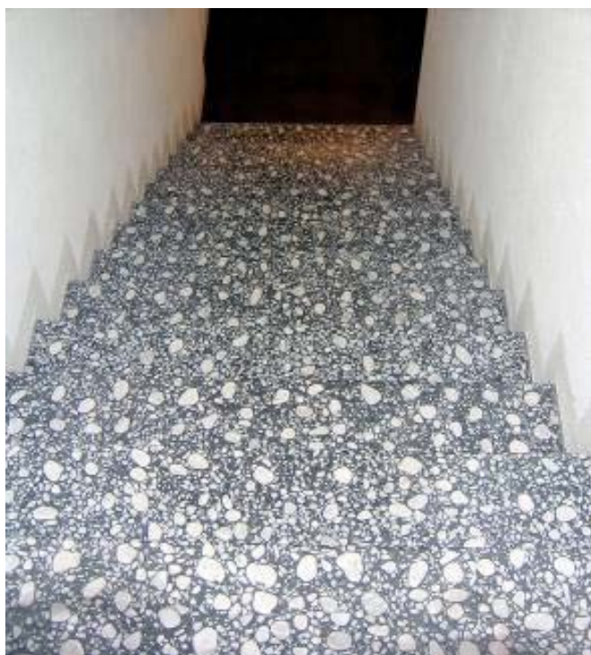
Treppenanfang und Stufenweite infolge falscher Materialwahl und Beleuchtung nicht erkennbar
