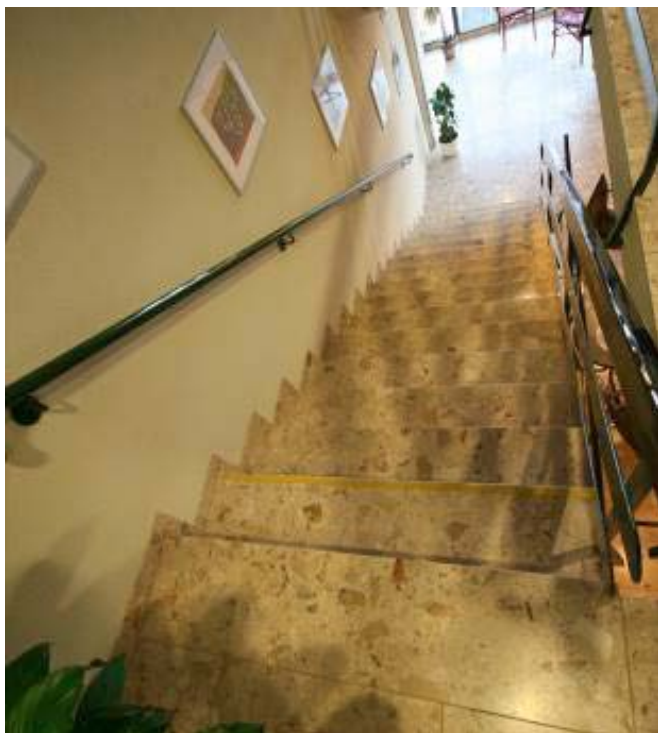
Treppe in einem Pflegeheim: falsche Materialwahl, verwirrende Schlagschatten, Blendung durch Spiegelung
