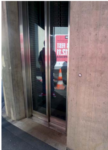
Bild 7: Ruftaster in Betonwand ohne kontrastierende Grundplatte
