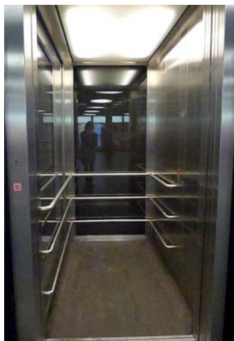
Bedienelemente nicht erkennbar
